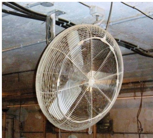
Figure 23 Système de brumisation du traitement BR
