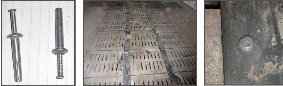
Figure 72 Utilisation de rivets en acier inoxydable et de longues plaques de métal pour boucher les « trous » à fumier des lattes de gestation
