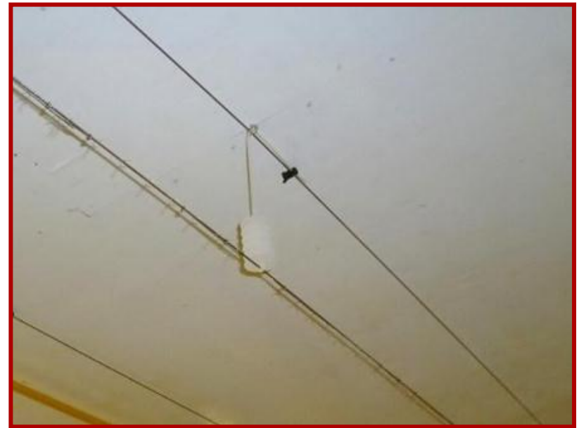
Ligne avec pointes et isolateur
